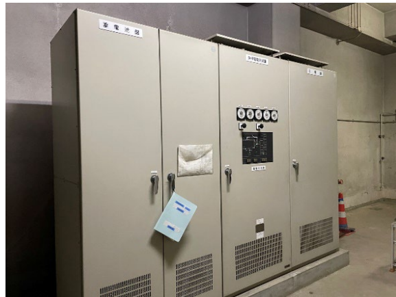
図 7-7 鶴見配水場無停電電源装置（既設、更新対象）
