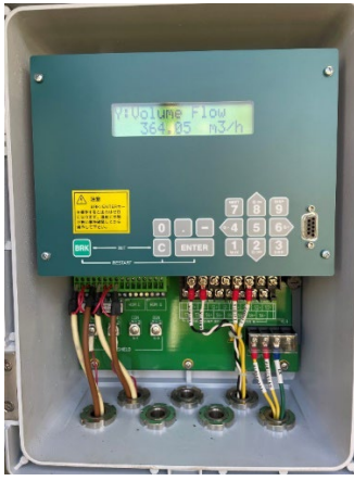
図 7-6 桜宮配水場流量計変換器（更新後）
