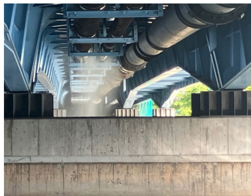
図 8-3 都島区の水管橋の漏水（令和 6 年 8 月）
