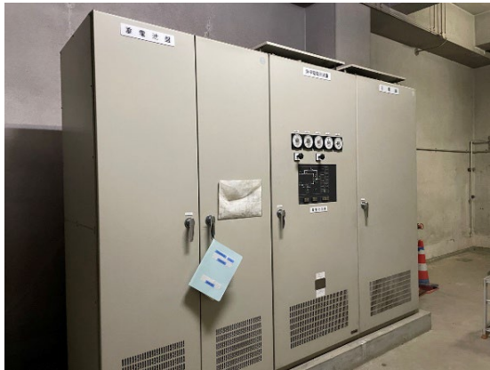
鶴見配水場無停電電源装置（既設）
