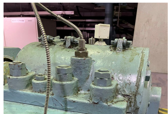
鶴見配水ポンプ２号振動測定
