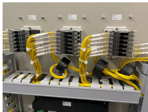
東淀川浄水場 配水ポンプインバータ盤 （ノイズ対策）
