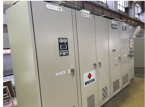
桜宮配水場無停電電源・直流電源装置（既設）
