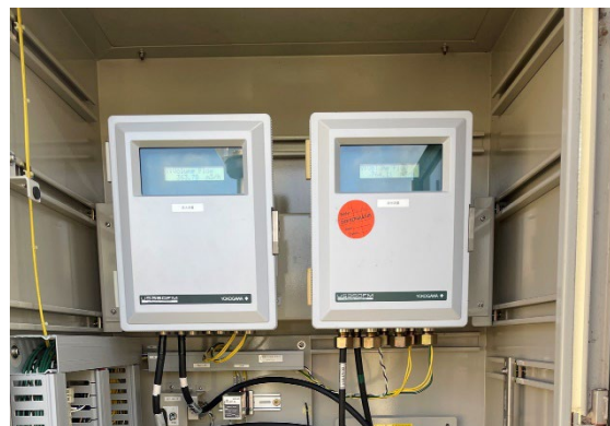
桜宮配水場流量計（変換器）
