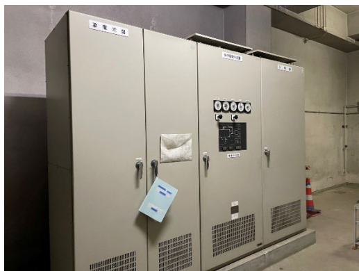
鶴見配水場無停電電源装置
