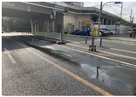
吉野4丁目：漏水状況
