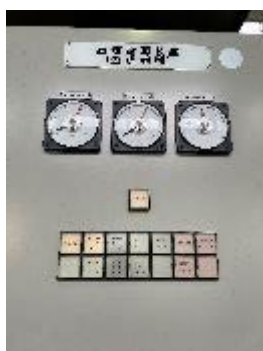
直流電源装置：鶴見配水場
