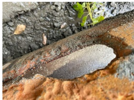
漏水箇所：大野3丁目
