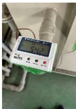
状態監視装置（温度計）：鶴見配水場
