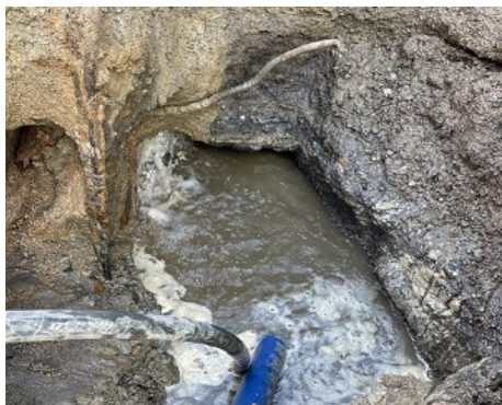
写真 突発漏水状況
